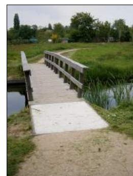
Verzakking opgevangen door stelconplaat
